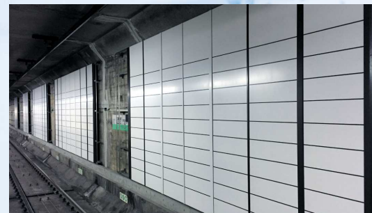
地下鉄構内壁面 (キズ・汚れ防止)
